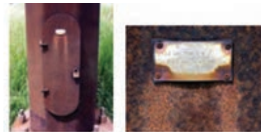
تشکیل پیل گالوانیک به دلیل نصب پلاک و قفل از جنس آلیاژ مس روی ستون فولاد کربنی
