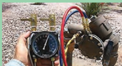
شکل ۱۷- تنظیم فشار شیر فشارشکن
