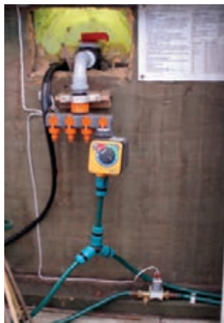
بخشی از سیستم آبیاری اتوماتیک
