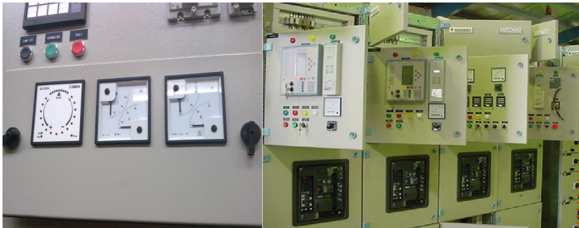
وسایل اندازه گیری در تابلو برق
