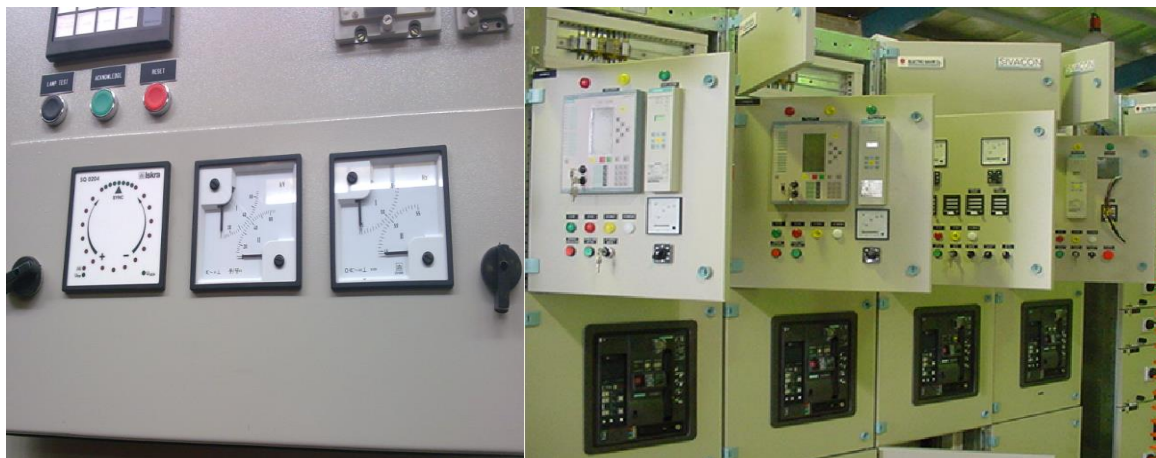
وسایل اندازه گیری در تابلو برق
