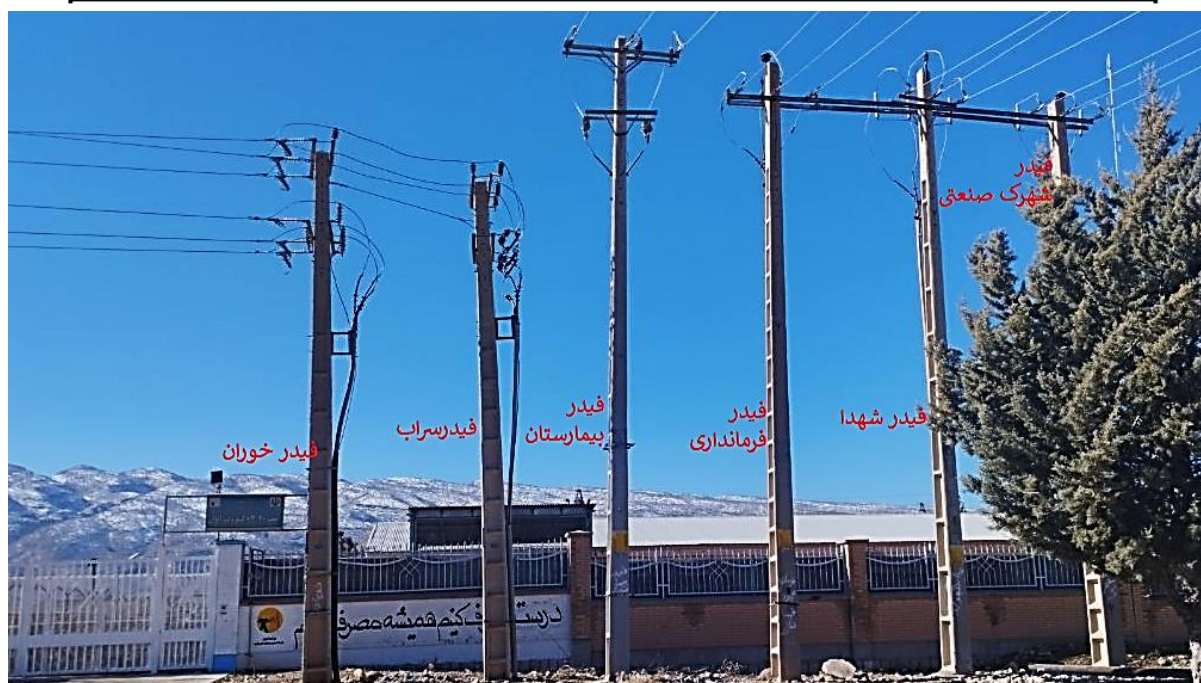
فیدر های خروجی پست ۶۳/۲۰KV شهر ایوان
