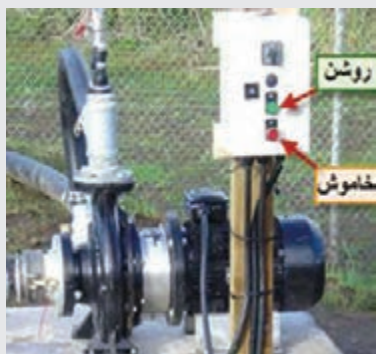
شکل ۲۰- کلیدهای کنترل روی تابلو
