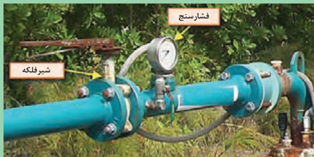
شکل ۱۳- محل شیرفلکه و فشارسنج روی لوله رانش
