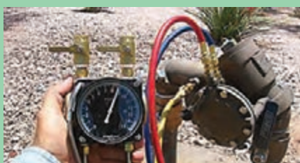
شکل ۱۷- تنظیم فشار شیر فشار شکن
