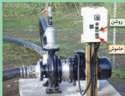
شکل ۱۴- کلیدهای کنترل روی تابلو
