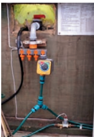
بخشی از سیستم آبیاری اتوماتیک
