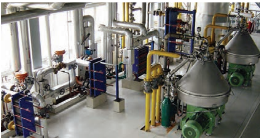
شکل ۶- سیستم خنثی‌سازی مداوم روغن
