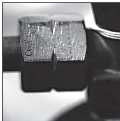
شکل ۱۰- شیر تنظیم گازهای اشتعال‌پذیر
