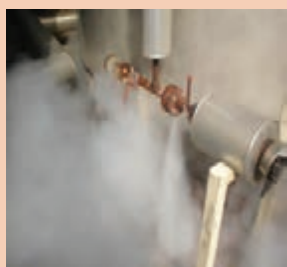
نشتی از اتصال در خط لوله
