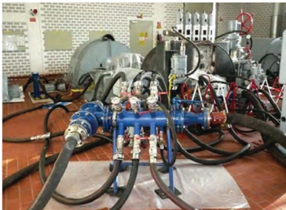
شکل ۲۳- سامانه تمیزکاری کمپرسور
