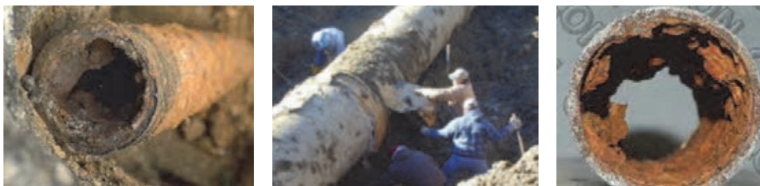
شکل ۴- نمونه‌ای از خوردگی لوله‌های دفن شده
